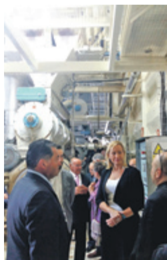
Recorrido por el interior de la nueva planta.
